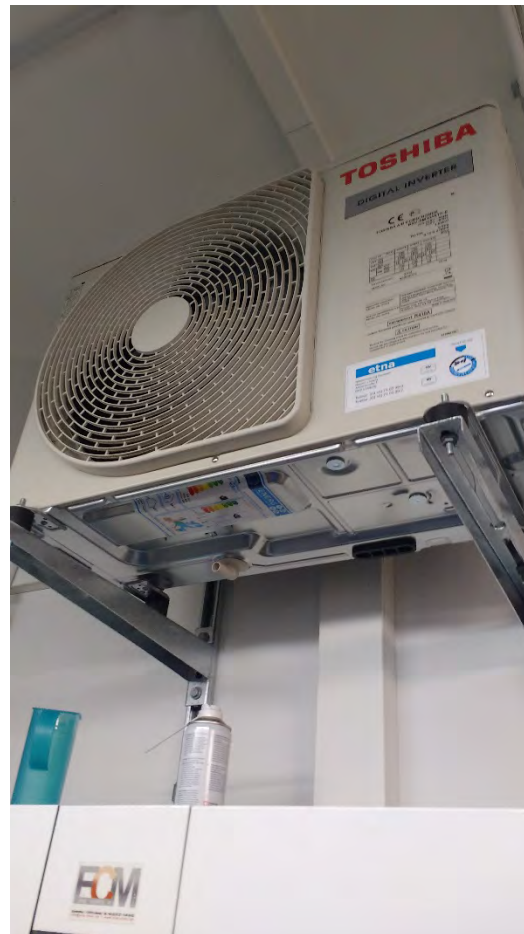
im Raum AirCon Outdoor Unit
